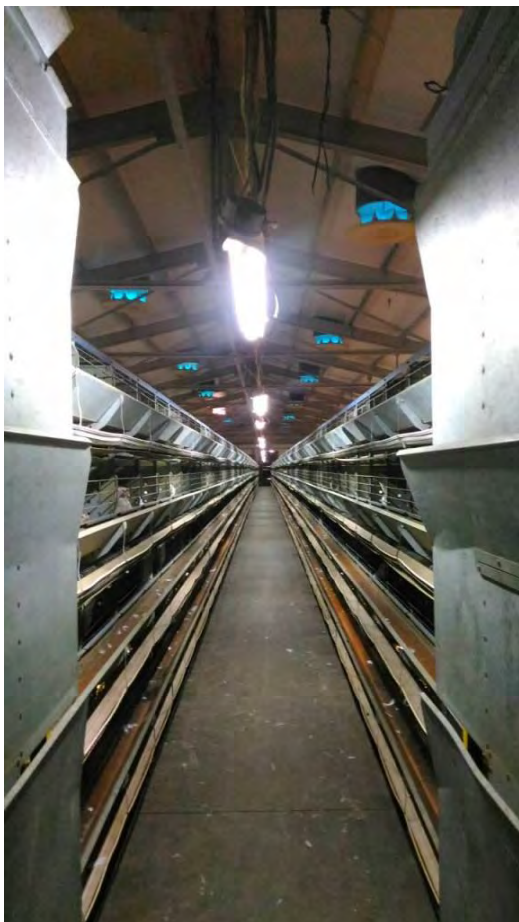
Фото 1 – Люминесцентное освещение в птичнике родительского стада размерами 18x79. Расстояние между светильниками 3,5 метра
