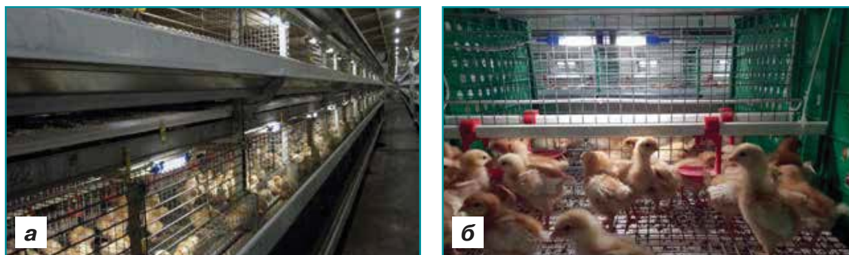
Рис. 4. Комбинированный способ освещения клеточного оборудования для содержания ремонтного молодняка, при котором светильники расположены на краю клетки со стороны прохода между батареями (а) и между двумя клеточными отсеками (б)
